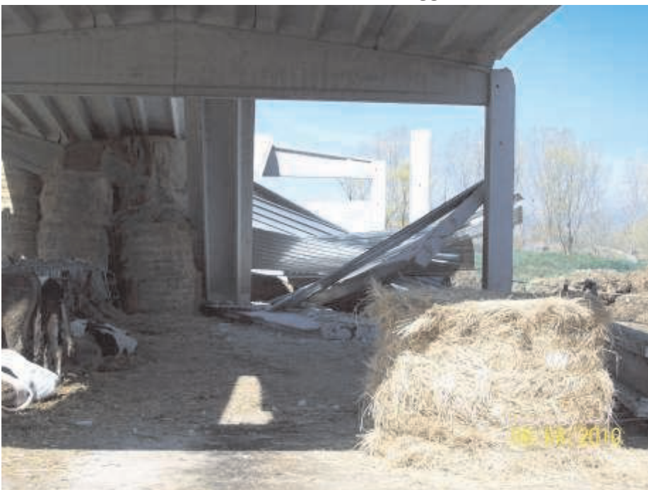
Stalla crollata a causa del sisma del 06 aprile 2009
